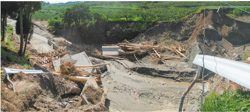
2017年7月の九州北部豪雨で決壊した農業用ため池
