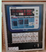
自動換気装置
