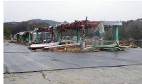
被災した養殖かき浄化施設(宮城県石巻市)
