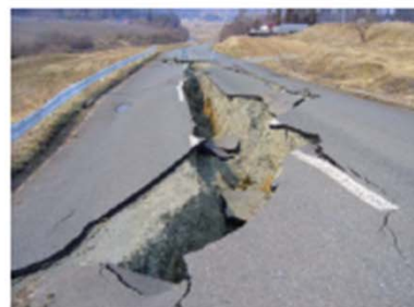
破損した農道(岩手県奥州市)
