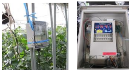
低コスト環境計測・制御盤
