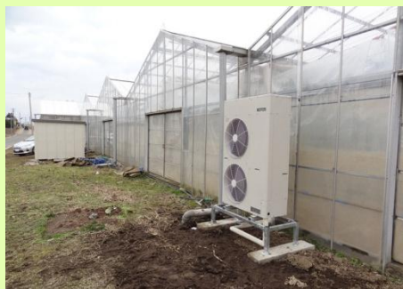
空気熱源ヒートポンプ室外機
