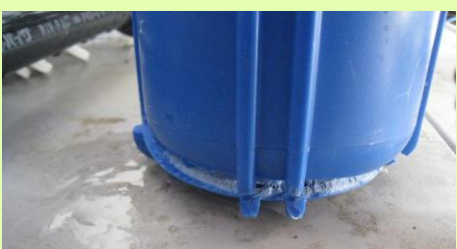
凍結によるフィルターハウジングの破損
