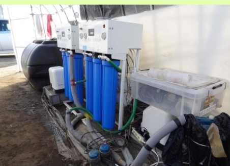
逆浸透膜装置(亶理町、日浄水量約2t)
