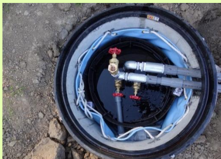
地下水熱源ヒートポンプ用熱交換タンク
