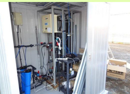
逆浸透膜装置(岩沼市、日浄水量約8t)
