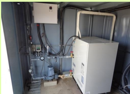
地下水熱源ヒートポンプ室外機
