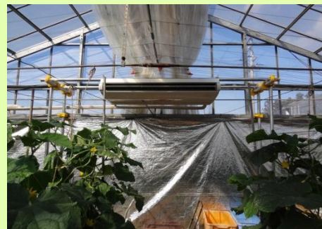
地下水熱源ヒートポンプ室内機
