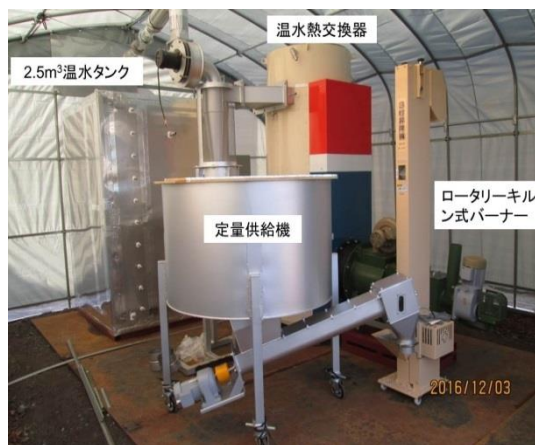
図 1-2 木質バイオマス用温湯式暖房システム
