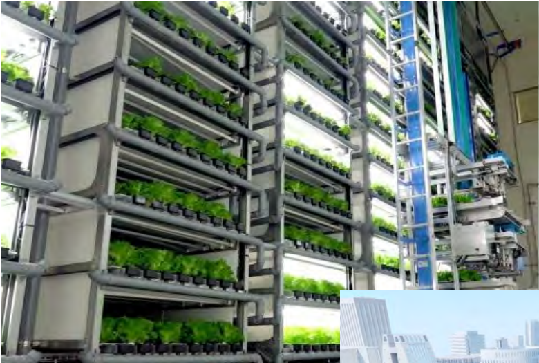
生産自動化システム
