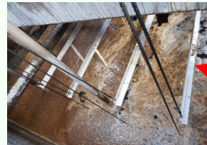
曝気槽内の炭素繊維リアクター
