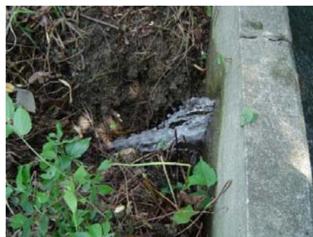
セメントモルタルによる補修後のひび割れ
