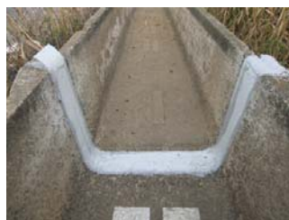
シーリング材の硬化
