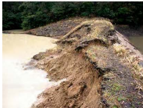
ため池堤体の崩壊状況
