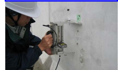
摩耗量の計測状況
